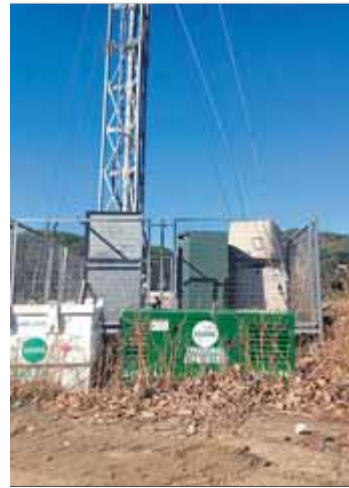
L'antena de telefonia que funciona amb un generador ■ E.F.
